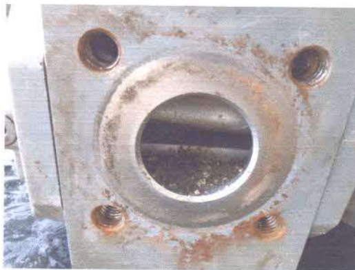
Fotografía 2. Interior del medidor. Antes de mantenimiento.
